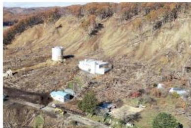
浄水場（富里地区）の被害状況
