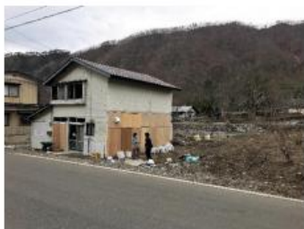
修繕費が足らず、トイレがなくなったままの住宅
