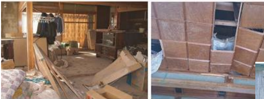
石巻市北上地区／独居老人世帯／ 制度の活用はしたが、修理できていない場所が多い。自己負担が必要な制度が使えない。
